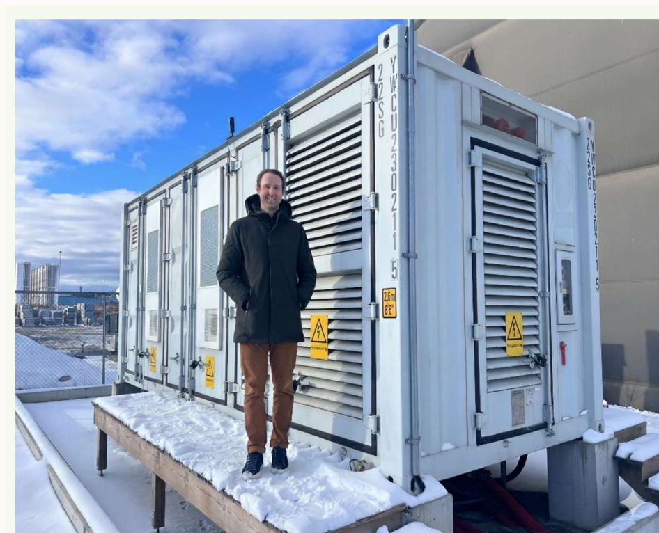
Modulbasert batteri installasjon 1MW/1,1MWh
